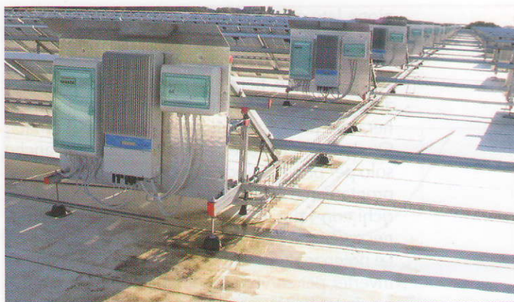
▲ Figura 2: Inverter posizionati sul retro delle strutture di sostegno dei moduli fotovoltaici
