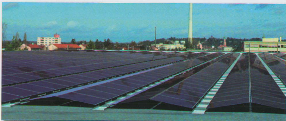
▼ Figura 3: Moduli fotovoltaici su tetto piano con bassa inclinazione e orientamento Est-Ovest
